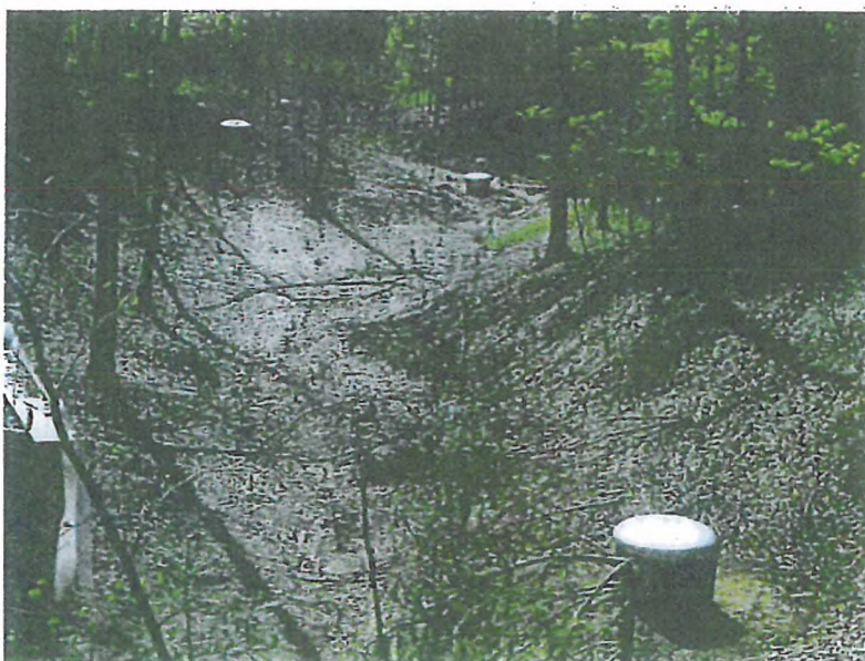
Überblick über die sanierten Fassungsanlagen: Einstiegsschacht SB 1.1 (vorne), Einstiegsschacht SB 1.2 (hinten links), Sammelbrunnstube (hinten rechts)
